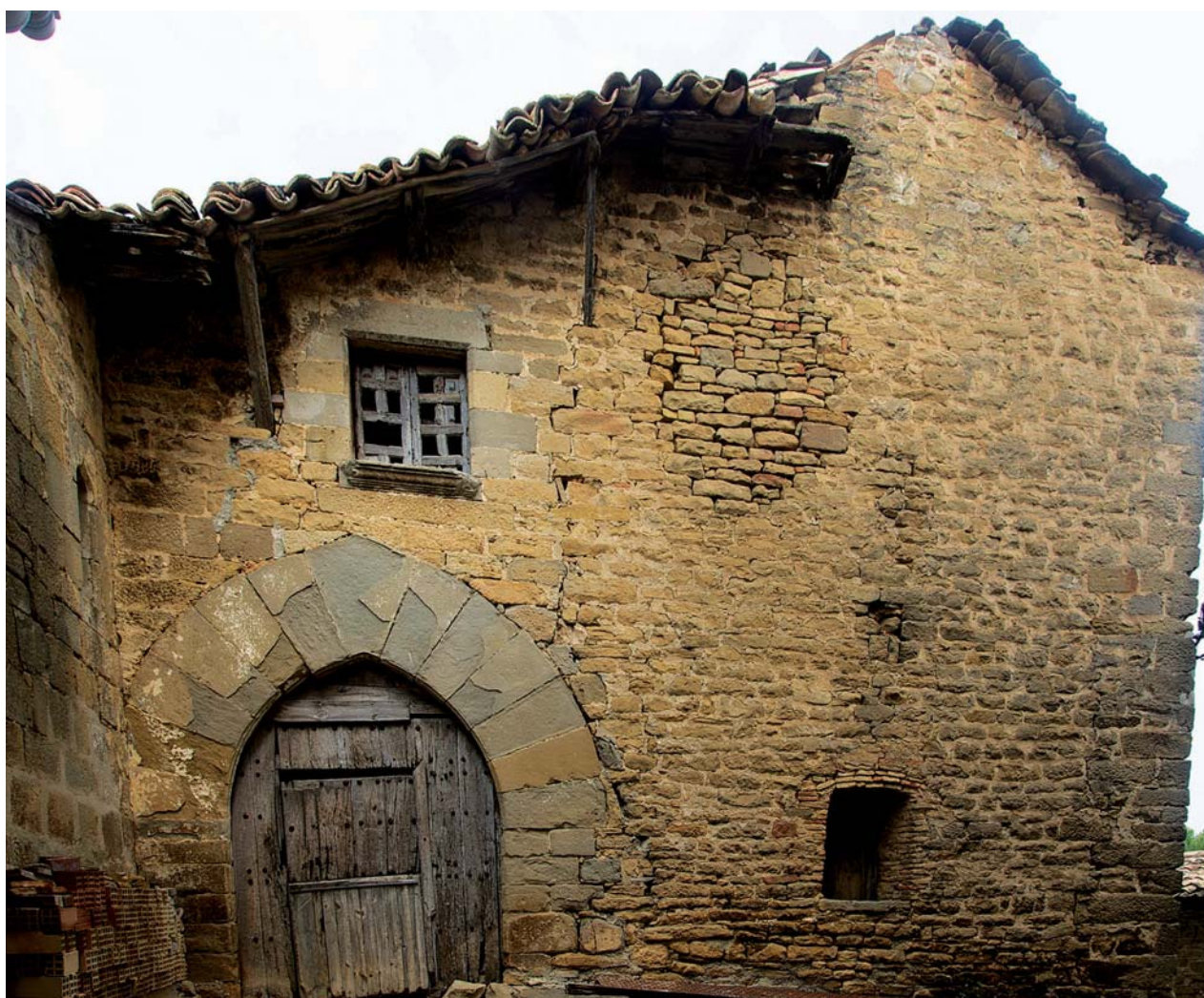
Fig. 52. Casa en la calle San Pedro, a lado de la iglesia. © E.Tuduri.
