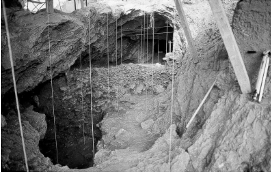
Foto 29.- Estado de la excavación antes de acometer la fase final de los trabajos.
