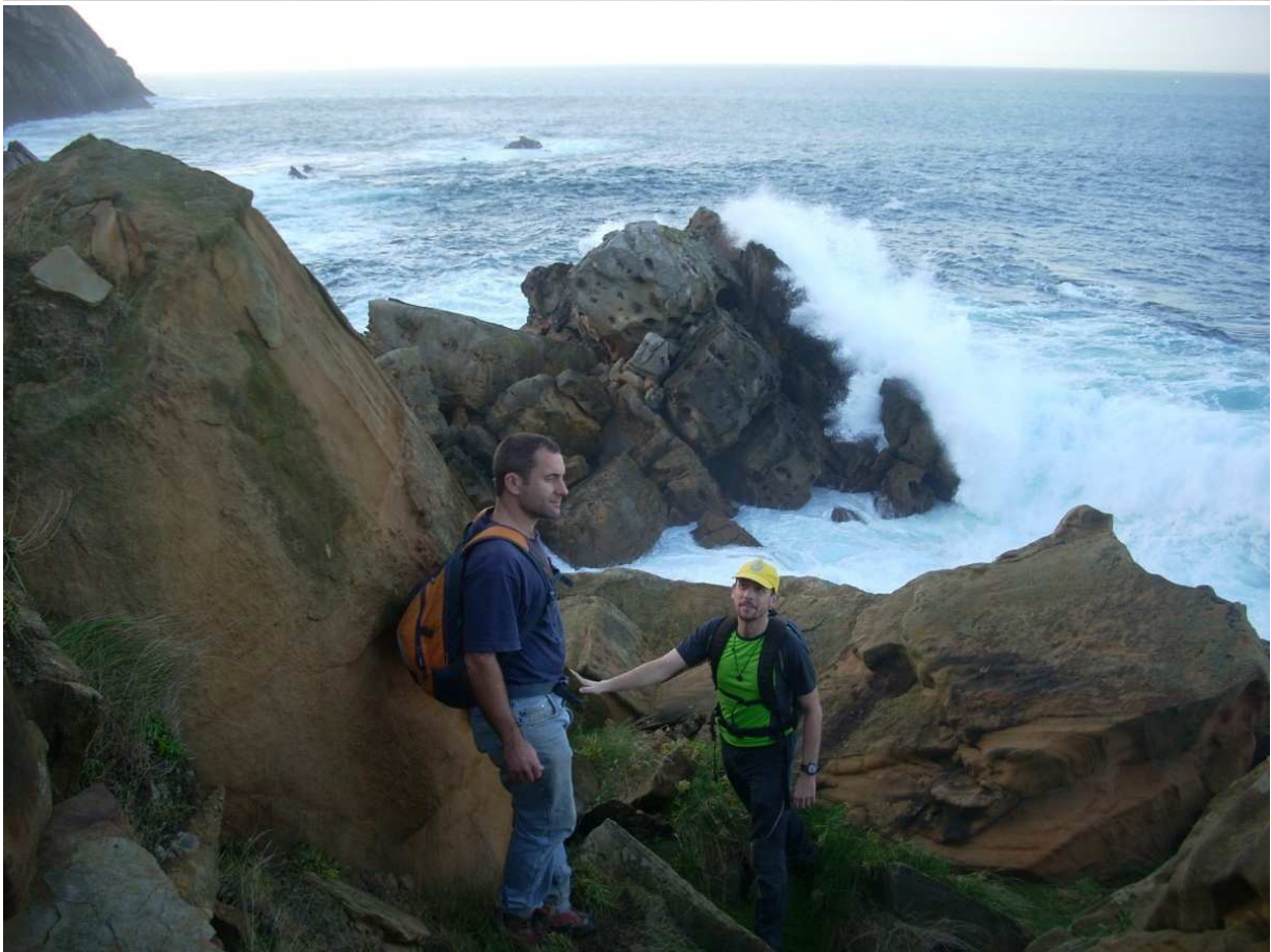
Figura 25. El acantilado frontal de Bajo aundi entre la punta central y la oriental, con claros ejemplos de descompresión mecánica y colapso de bloques (imagen superior). Imagen inferior: el promontorio de la cueva grande en la punta central batido por el oleaje con mar de fondo.
