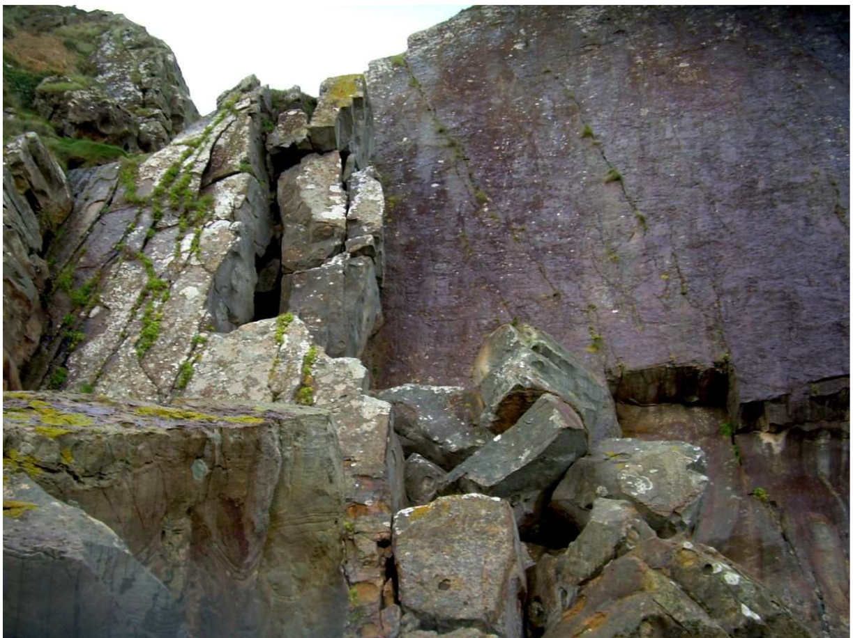
Figura 6. Zona de acceso a la punta central de Bajo aundi, con concavidades y geoformas (imagen superior). En la imagen inferior se aprecia el acantilado de descenso, visto desde abajo, con paneles de bloques a medio desprender y desprendidos. La pared del acantilado frontal tiene 50 m de altura y los bloques de colapso varios metros de lado.
