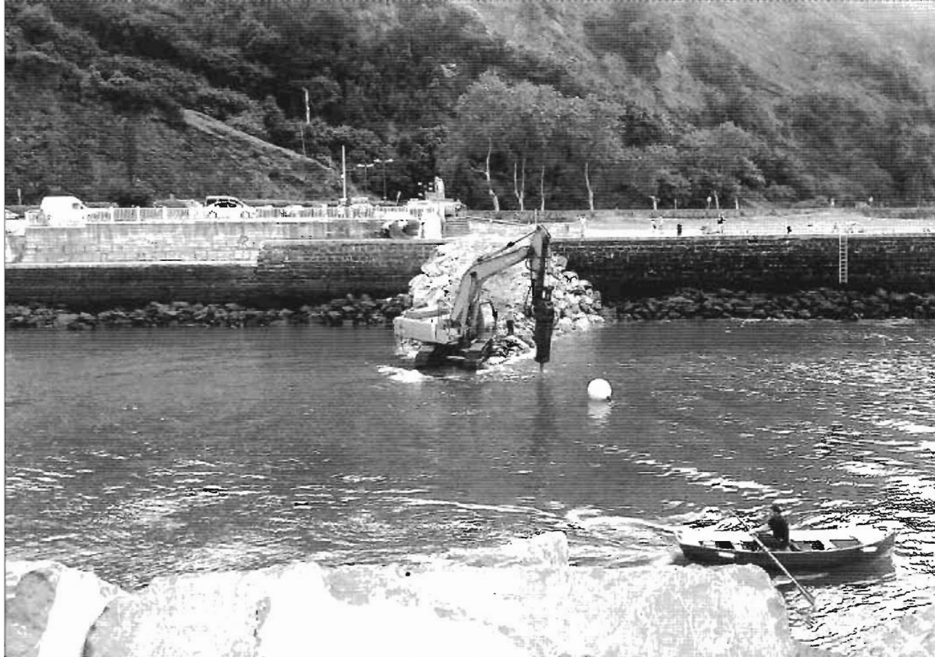
Una máquina trabaja en el lecho del río para eliminar los peligrosos estratos rocosos.
