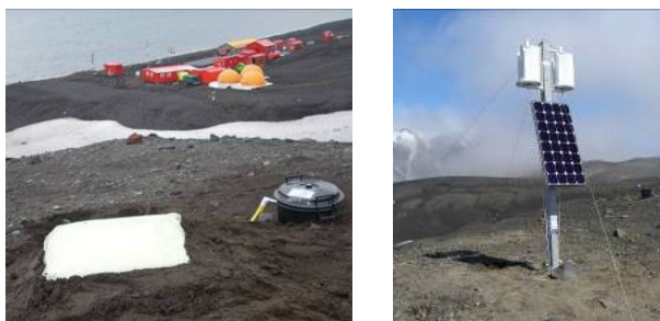
Figura 6. Imágenes de la estación y los paneles solares y generadores eólicos de la estación permanente de Isla Decepción ( View of the solar panel and wind generators installed at the permanent seismic stations at Deception Island in February 2008 )
