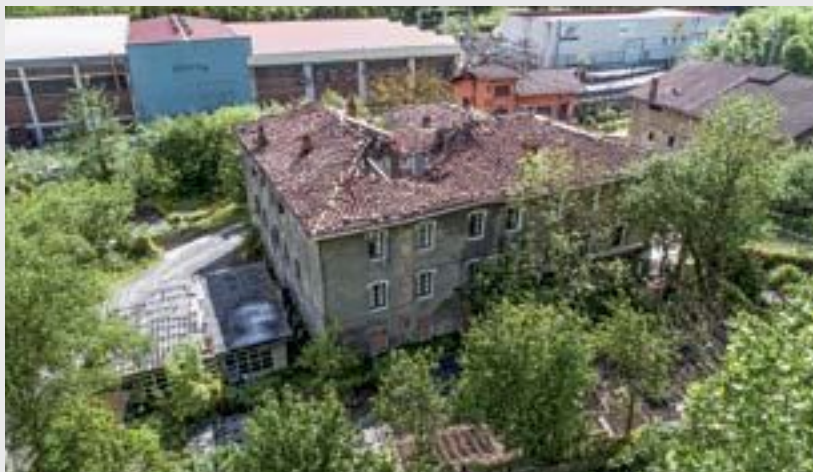
Vista del conjunto de Olaberria (Legazpi) con el sector de la cubierta hundida en primer plano.
