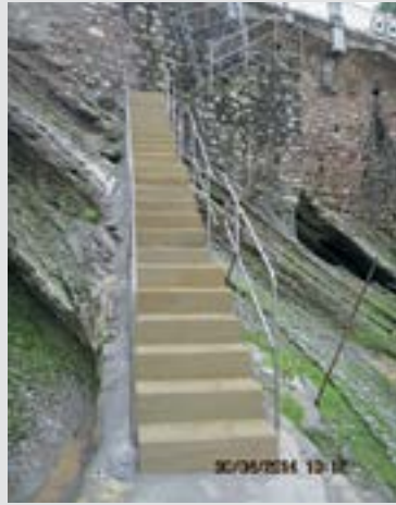
Figura 7.2. Escaleras reconstruidas (30-04-2014). www.miteco.gob.es
