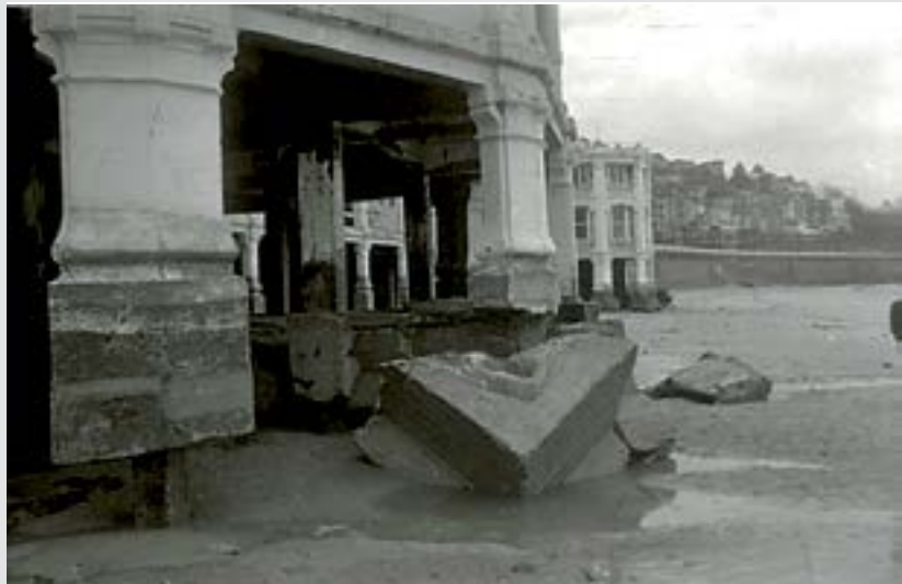
Figura 1.1. Destrozos por un temporal de mar en el antiguo edificio del balneario de La Perla (18-01-1965). https://www.kutxateka.eus
