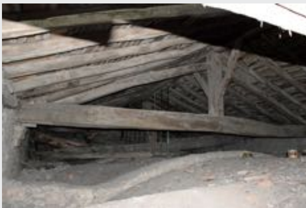
Imagen actual de la cubierta de la Iglesia del Convento de los Capuchinos (Hondarribia), con la viga fracturada. M. GARCIA
