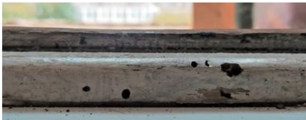
Agujeros de carcoma en una vivienda de Errenteria.
