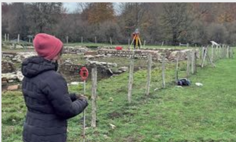
Zalduako termen konsolidatu osteko harrizko egituren itxura. Behean, Zalduako termen konsolidazio lanen drainatze zangaren erregistroa egiten estazio totalarekin. 📷 E. MARTINEZ
