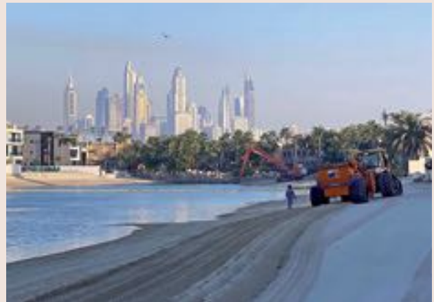
Figura 4. Tractor de oruga tirando de despedregadora (03-05-2023).
