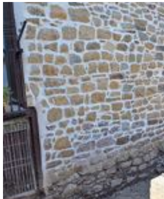
Detalle del lienzo de la antigua muralla renacentista documentado en el solar de Orereta kale nº 5 (Erretería), reaprovechada como cierre de la casa. 📷 A. MORAZA
