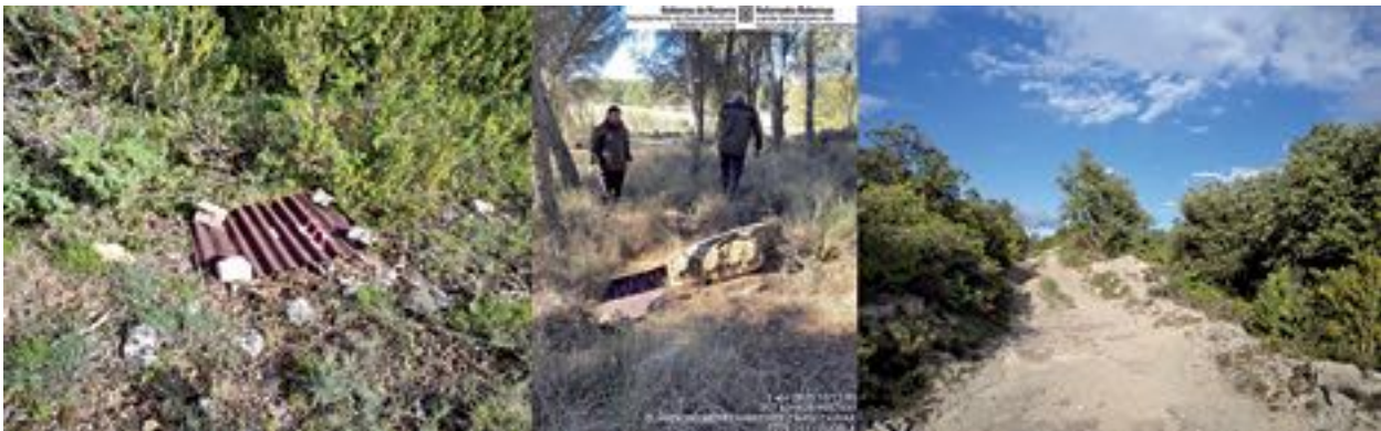
Distintas fotografías tomadas en el proceso de colocación de las placas bituminosas. 📷 GUARDAS FORESTALES DE NAVARRA
