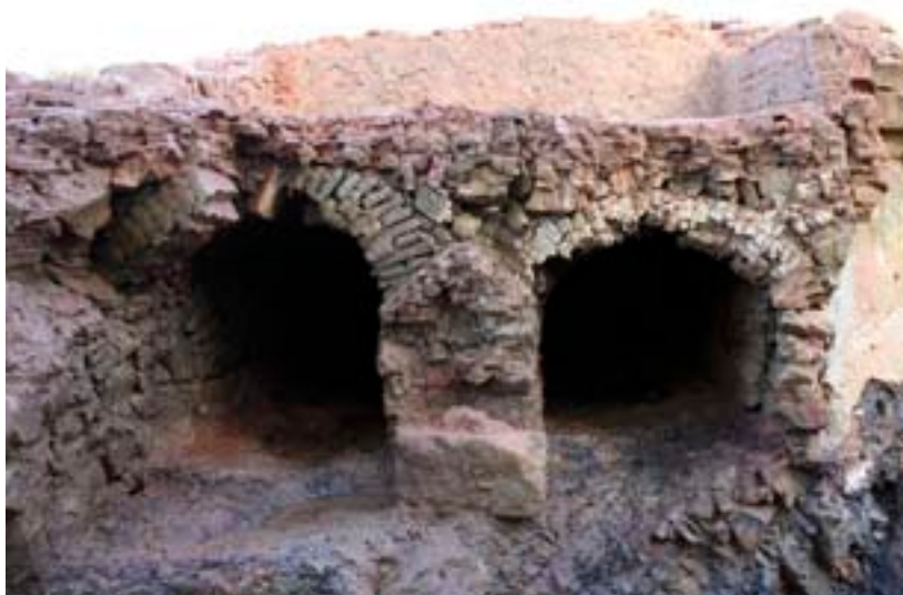
Fachada principal de la tejera de Telleria (Meñaka) parcialmente dañada por los trabajos de urbanización del área. En primer plano las bocas de la cámara de combustión. © A. Moraza
