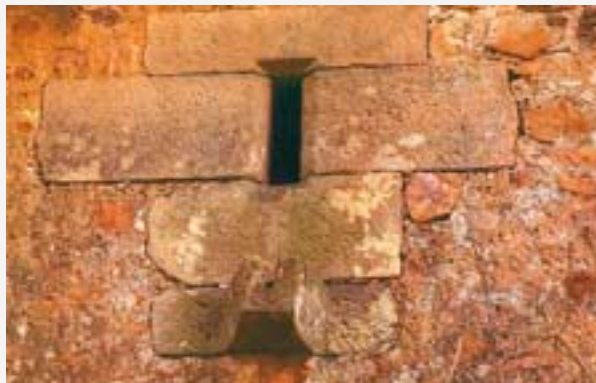
Detalle del alfeizar moldurado situado en la fachada Oeste del caserío Tobar (Errenteria), originalmente destinado a la vertedera de aguas de la cocina del edificio. © J. Buces
