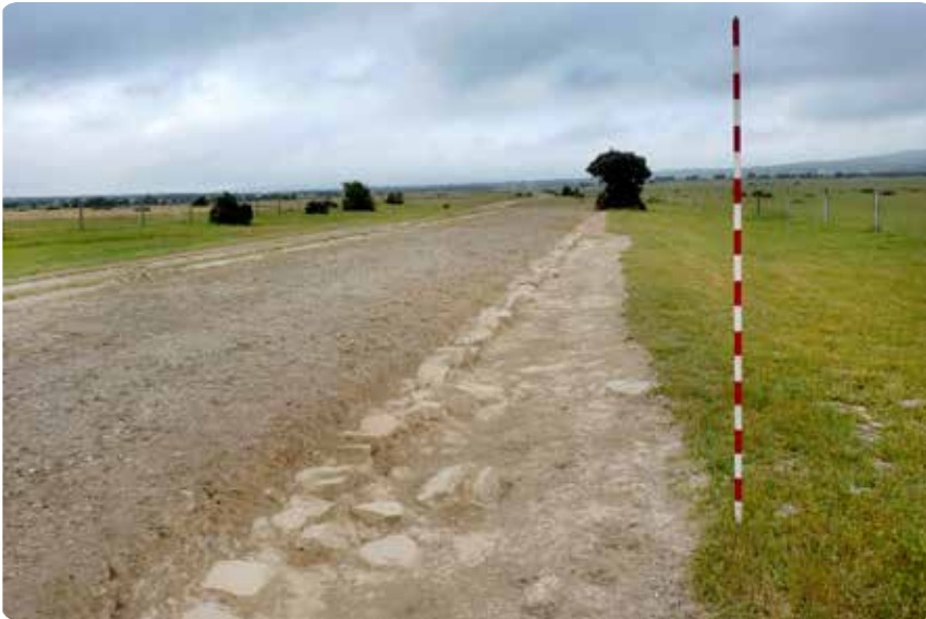
Fig. 15. Vista parcial del bordillo occidental de la calzada en la milla 154, en el transcurso de los trabajos de limpieza y excavación.
