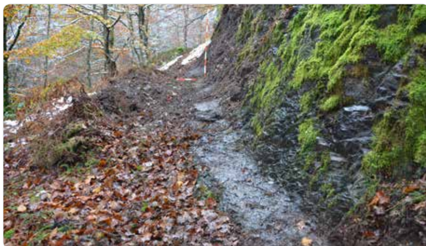
Fig. 90. Plataforma con necesidad de muros de contención.
