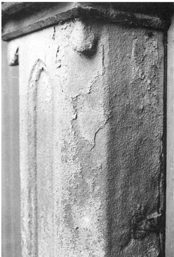
Figura 1. Detalle del deterioro y de la formación de capa en arenisca (Iglesia de San Vicente de San Sebastian).
