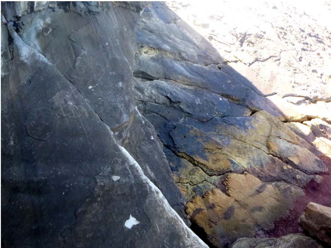
Figura 14. Detalle de las mallas de fracturas en estratos, con bordes dentados, por el colapso de fragmentos. Puede apreciarse pequeñas filtraciones laminares que emergen entre los planos de estratificación. En la imagen inferior, la continuación del abrigo sobre la placa de Banzukar, con fracturas y geoformas adicionales.
