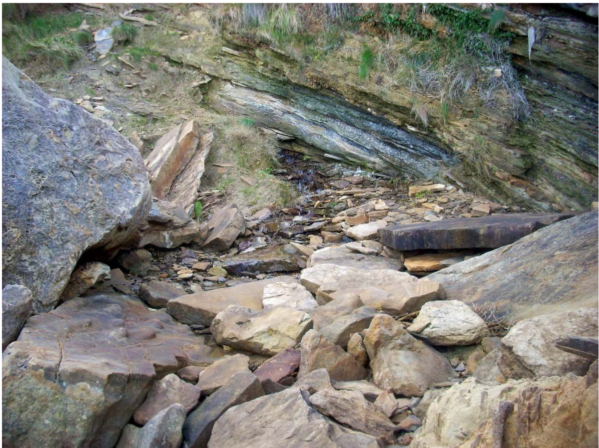
Figura 3. Los estratos delgados de lutitas se disgregan con facilidad y generan el colapso y deslizamiento de bloques de arenisca (arriba). En la base de los contactos de lutitas con arenisca es frecuente la emergencia de aguas subterráneas, que generan manantiales permanentes (debajo).
