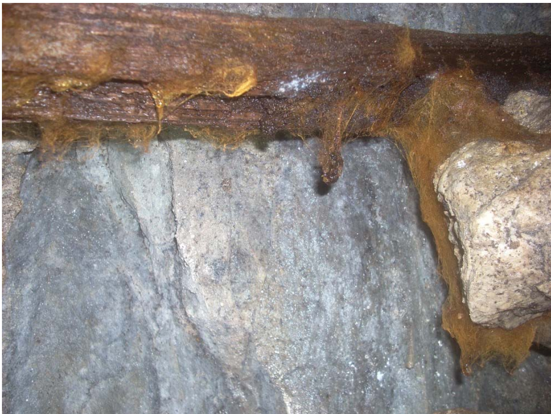
Figura 09. Restos de madera del entibado, en proceso de descomposición, con micelios de hongos y tapices de bacterias. De la trama ocre se desprende una larga manga reticular blanca que en su parte inferior se adhiere a la pared formando una membrana negra (arriba). La madera se desagrega en grumos negros, viscosos, que pueden quedar envueltos en los micelios (debajo). Nótese la diversidad de coloraciones.
