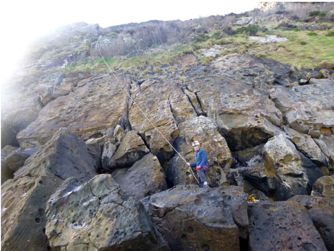
Figura 20. La rasa mareal queda emergida durante las bajamareas vivas (arriba). La zona basal del tramo subsidente de la placa presenta numerosas fracturas, debidas a los desplazamientos y roturas mecánicas (debajo). En la imagen se aprecia las dos grandes fracturas, a E y W, que han propiciado el deslizamiento del tramo.
