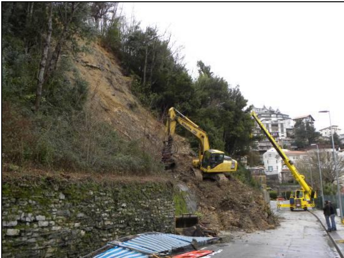
Figura 18. Desprendimiento de la ladera en la antigua cantera de Arbizketa o Arrobi en enero de 2013.
