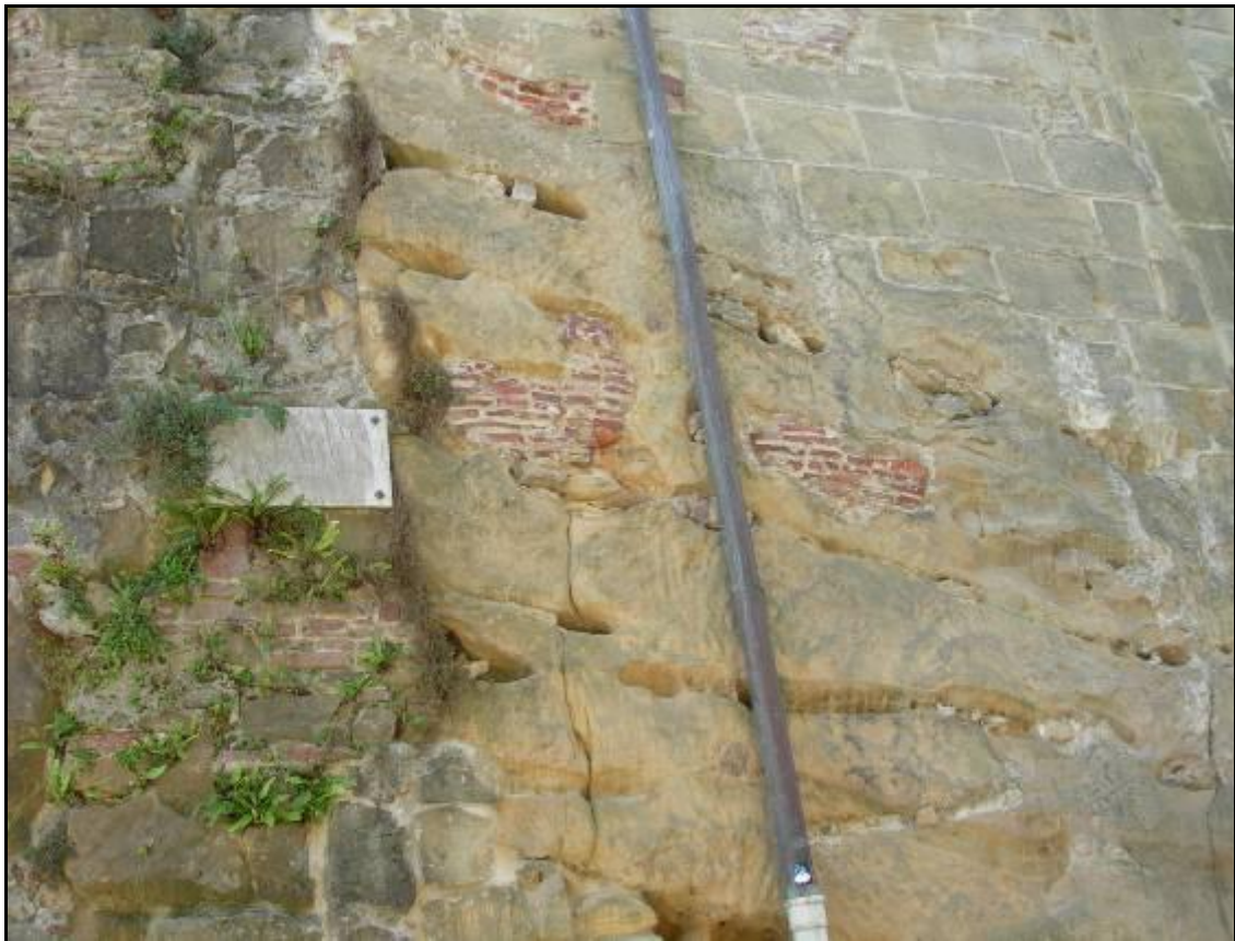
Figura 11. Reparaciones similares con ladrillos macizos en el Macho del Castillo Roquero de Urgull.
