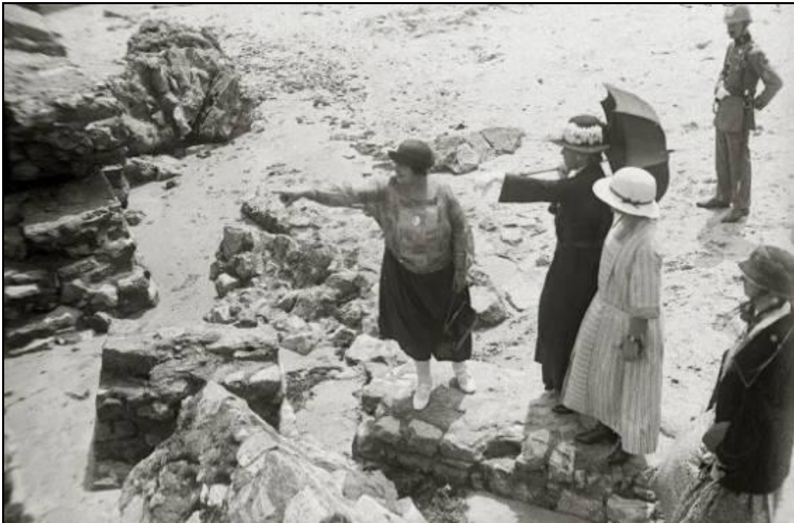
Figura 10. La reina Maria Cristina (de negro y con sombrilla) sobre la cimentación desplazada del muro de costa en 1923. Autor: Pascual Marín. Archivo Kutxa Fototeka. https://www.kutxateka.com/index.php/Detail/Object/Show/object_id/276831
