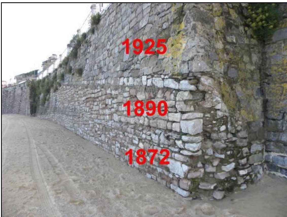
Figura 4. Muro de costa del antiguo campo de maniobras (1872), levante del muro tras construcción del túnel del Antiguo (1890) y construcción del muro de los jardines de Ondarreta (1925).
